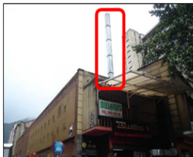
Foto 4. Ducto de extracción de la parrilla de asado de carnes
