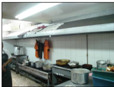
Foto 1. Campana de extracción de las fuentes en la cocina.
