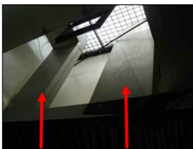
Foto 2. Ducto de extracción da las fuentes de la cocina
